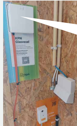
Glasvezel-aansluiting in de meterkast
